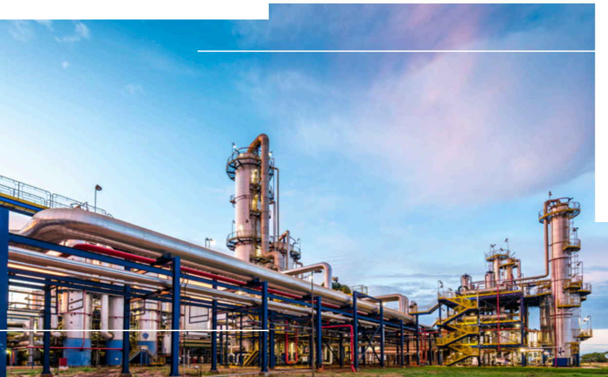
A Unidade Eldorado, no Mato Grosso do Sul – capacidade de moagem de 3,5 milhões de toneladas de cana por safra
