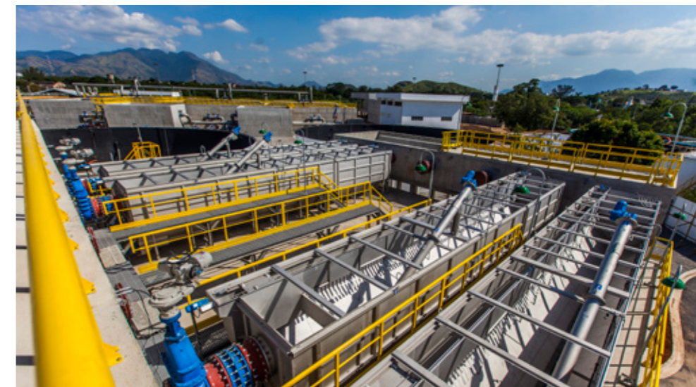
Na ETE Deodoro, no Rio de Janeiro, a água é reutilizada para a desobstrução de galerias, redes de esgoto e lavagem de vias
